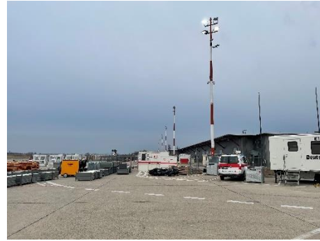
Ersatzstromerzeuger ESE 300 am ehem. Flughafen Tegel (Quelle: Wiesener/ DRK)
