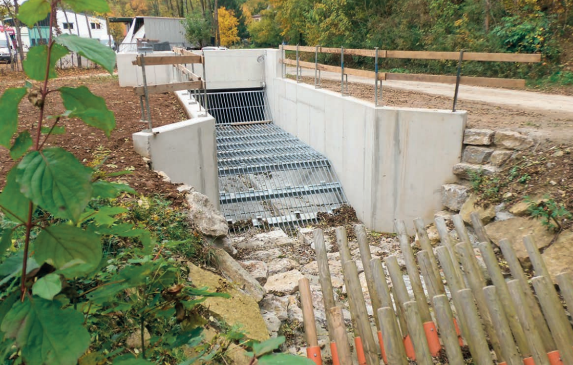
Abb. 78: Neue gebauter Kanalisationseinlauf an einem Bach. Bei Starkregen gilt es, diese Einmündungen immer offen zu halten, damit das Wasser in der Verdohlung bzw. in der Kanalisation abfließen kann.
