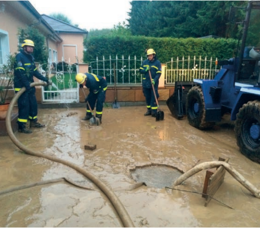
Abb. 23: Aufräumarbeiten nach einer Sturzflut in Sinsheim
