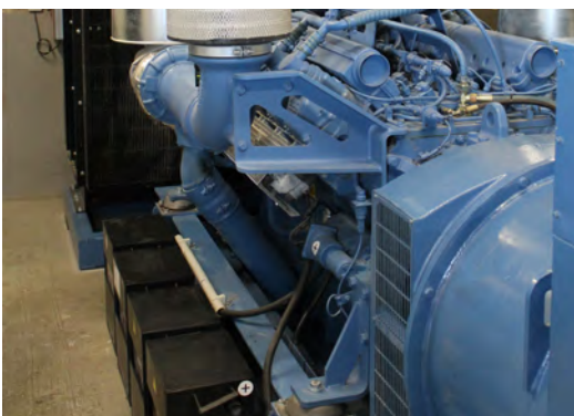
Abbildung 7 Netzersatzanlage (Quelle: BBK)
