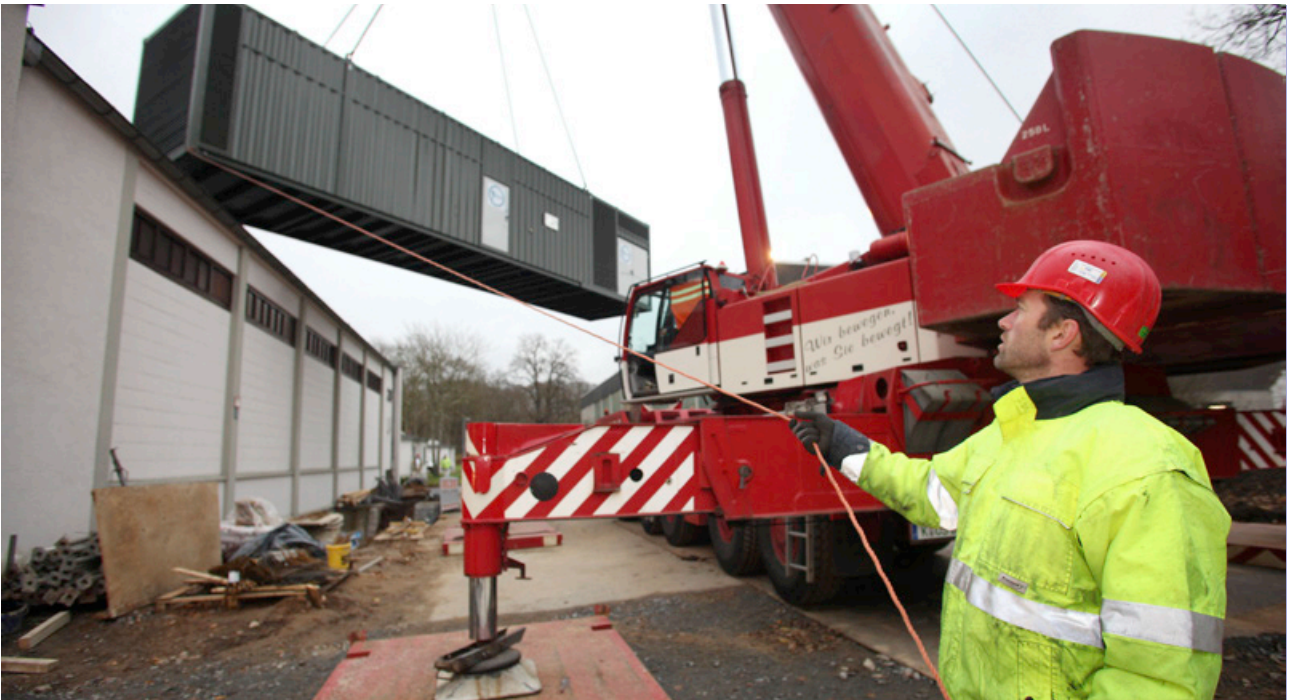
Einrichtung einer Notstromversorgung für ein Wasserwerk © Rheinenergie AG
