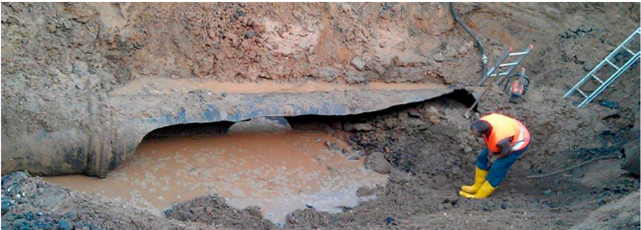
Rohrbruch, Wassertransportleitung DN 800 © Rheinenergie AG Köln
