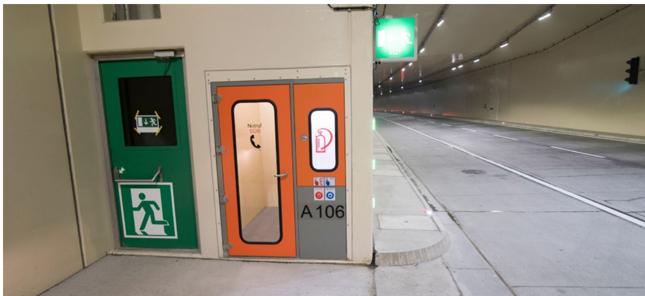
Abbildung 8: Notrufstation und Fluchtweg in Tunnelsystemen Quelle: Elmar Gubisch/Shutterstock
