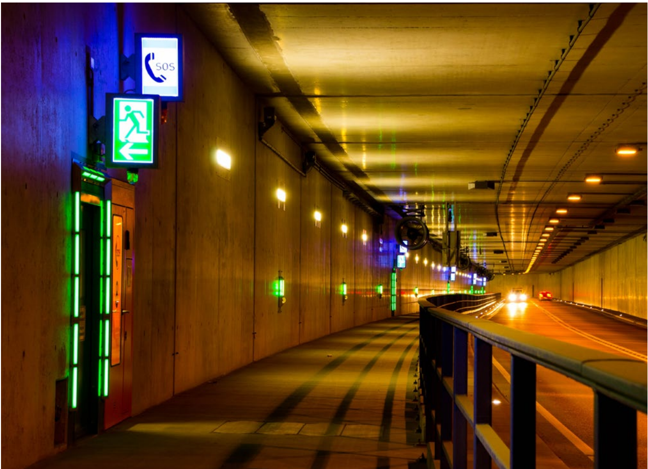
Abbildung 4: Notausgang, Flucht- und Rettungsweg; Notrufstation, Quelle: Pradeep Thomas Thundiyil/Shutterstock
