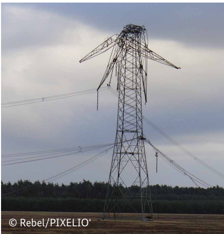
Sturmschaden durch den Orkan Kyrill im Jahr 2007
