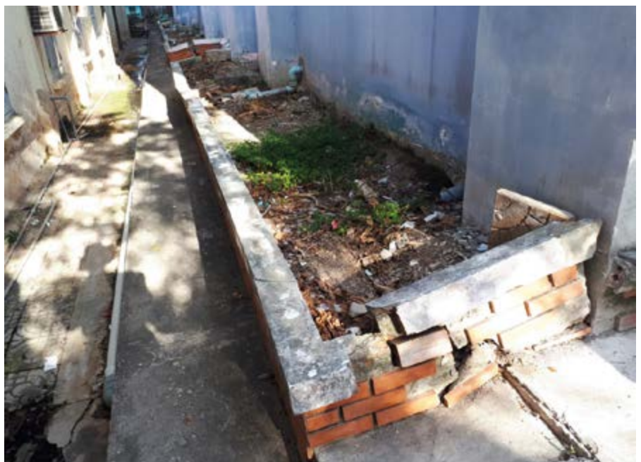
Abbildung 3: Auswirkungen der Bodenabsenkungen auf Gebäude in Ca Mau City, Vietnam. (Quelle: GIZ/Olaf Neussner)
