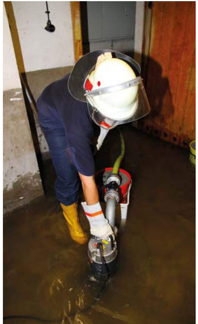
Abb. 2: Pumparbeiten im Keller eines Wohnhauses in Offenbach nach einem Starkregen 2012. (Quelle: S. Danisch, Feuerwehr Offenbach)
