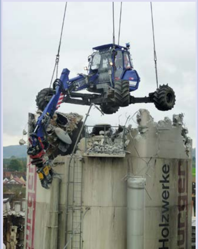
Auch aus knapp 70 m Entfernung erwies sich die am Kran hängende Rettungsspinne als gut fernsteuerbar.
