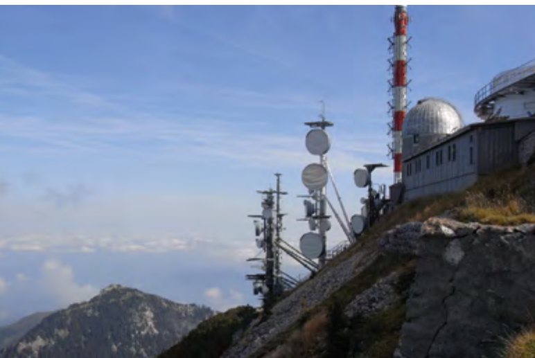
Warnmultiplikatoren, z. B. öffentlich-rechtliche Rundfunkanstalten und private Rundfunkbetreiber, erhalten Warnmeldung mittels MoWaS von den zur Auslösung befugten Stellen und haben sich verpflichtet, diese über ihre Netze zu veröffentlichen. (Foto: Gerhard Eichstetter / pixelio.de)
