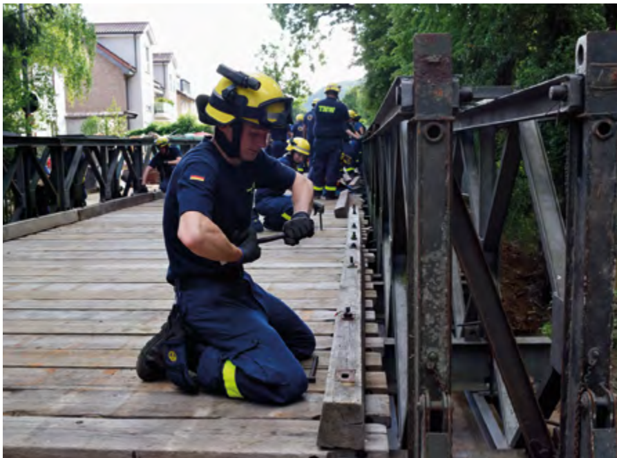
Alleinstellungsmerkmal Brückenbau: Im nordrhein-westfälischen Wachtberg bauten die THW-Kräfte beispielsweise eine Bailey-Brücke auf. (Foto: THW / Markus Schrems)
