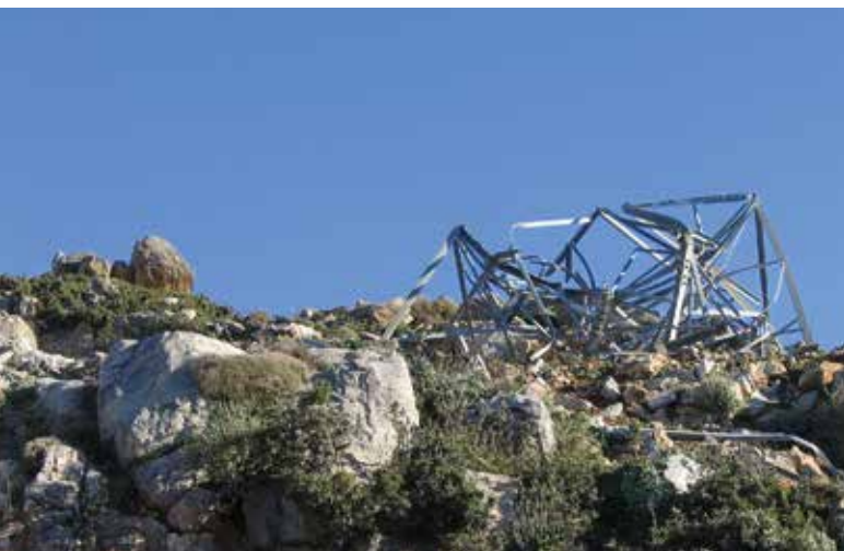
Die Behebung von Sturmschäden ist oft aufwendig und kann zu länger andauernden Engpässen führen. (Foto: ro18ger/pixelio.de)
