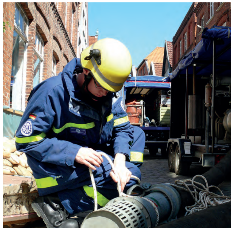
THW-Kräfte bereiten in Lauenburg (Schleswig-Holstein) den Einsatz einer Hochleistungspumpe vor. Diese Pumpen haben eine Leistung von bis zu 15.000 Litern pro Minute.
