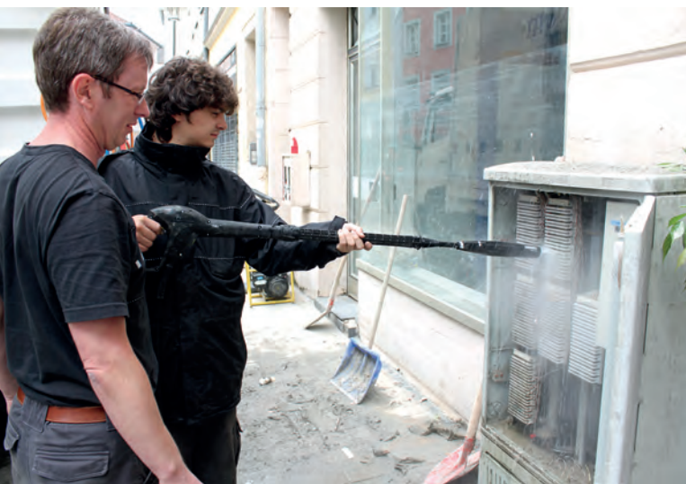
Wiederherstellung kritischer Infrastruktur. Die Arbeit des Verwaltungsstabes geht über den Einsatzzeitraum hinaus (Foto: Hubertus Kischkewitz / Deutsche Telekom AG)
