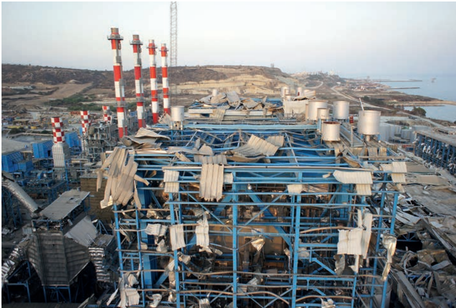
Blick aus ca. 70 Metern Höhe auf die beschädigten Boilergebäude, auf der rechten Seite die niedrigeren Turbinenhallen.
