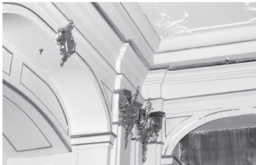
Nahezu unsichtbar: Die Düsen der Hochdrucknebel-Löschanlage im Rokokosaal verschwinden fast. (Foto: Stefan Wagner)
