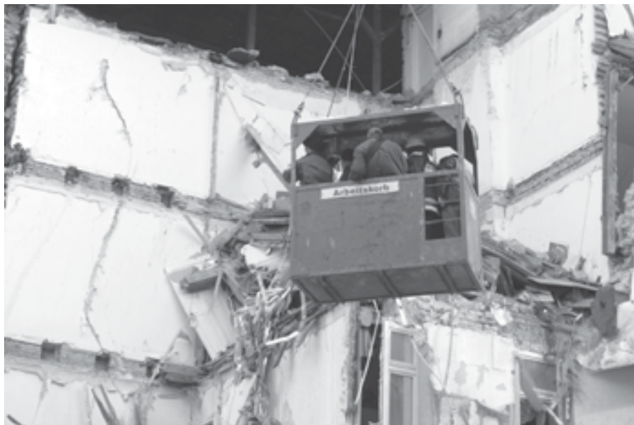
Aus dem Arbeitskorb des Krans begutachteten Feuerwehr und Polizei die Explosionsstelle, um die weiteren Einsatzmaßnahmen zu koordinieren.
