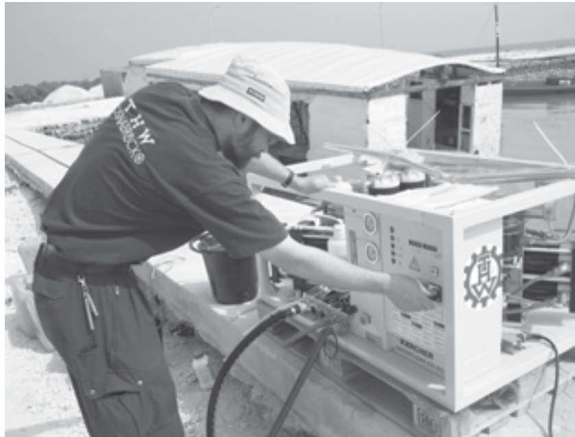
THW-Mitarbeiter an einer Anlage zur Umkehrosmose.
