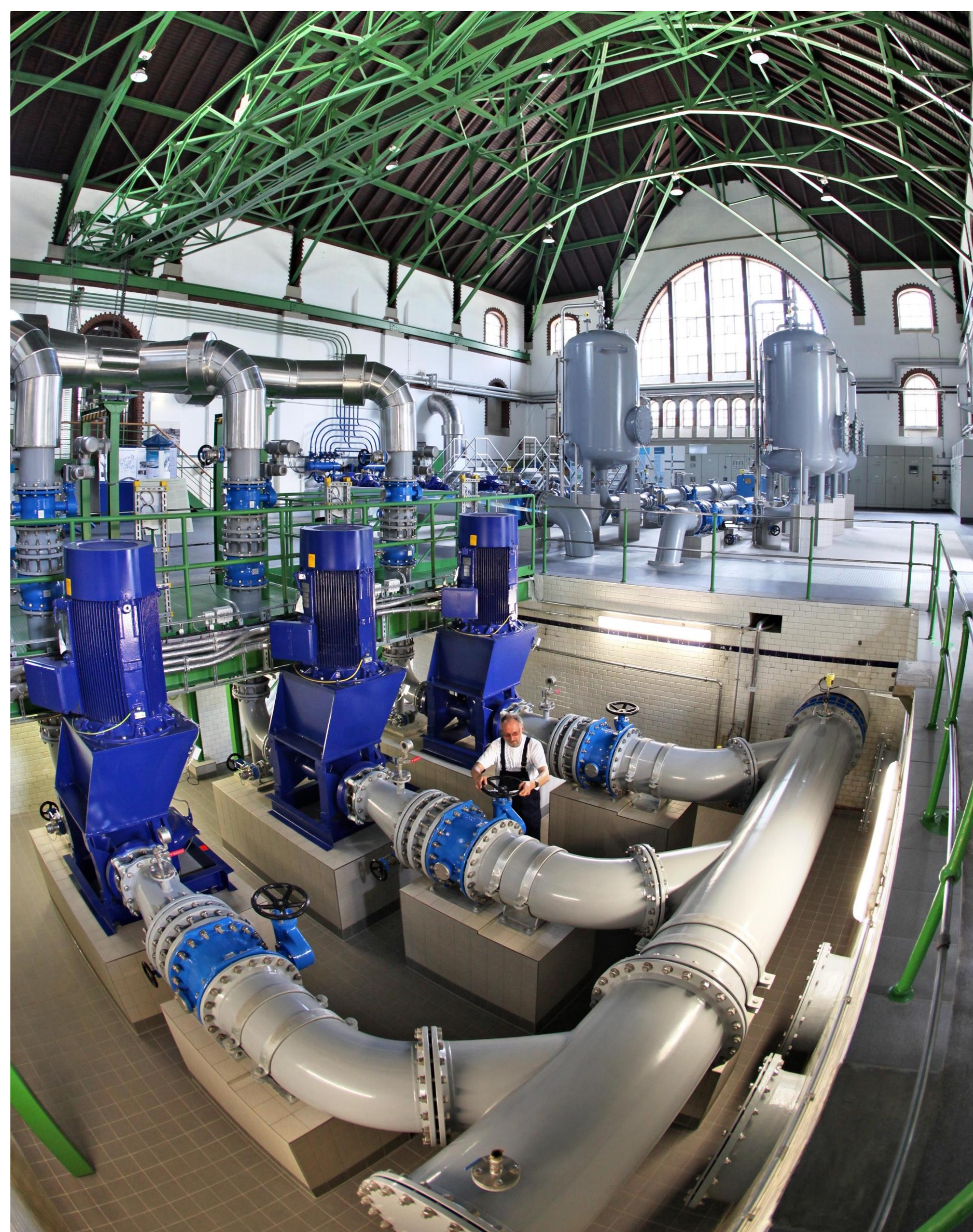
Die Bewertung der Kritikalität von Versorgungsinfrastrukturen ist eine wichtige Voraussetzung für den Prozess der Risikoanalyse und Risikobewertung (©Woitas „Wasserwerk Canitz“)
