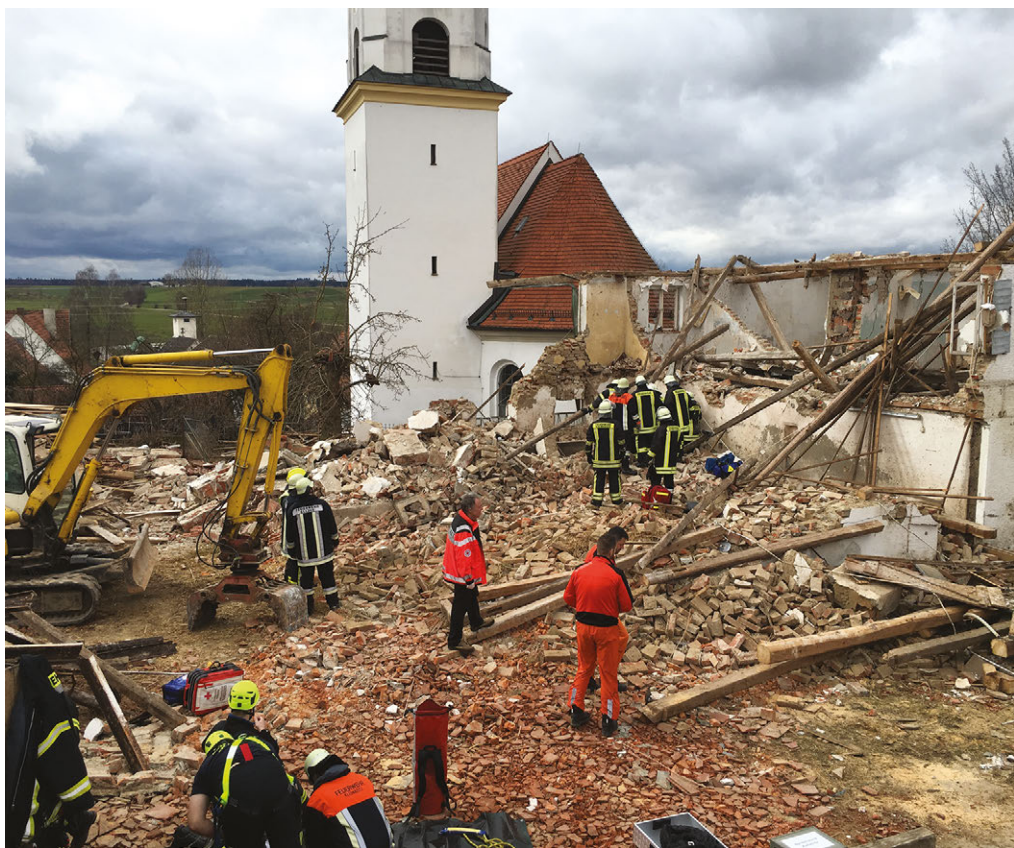
Abbildung 3: Bei Abrissarbeiten kollabiertes Gebäude mit Teilverschüttung eines Arbeiters. Auch in der zivilen (Katastrophen)medizin kommt es regelmäßig zu Ereignissen, bei denen es sinnvoll ist, Aspekte der Taktischen Medizin anzuwenden, beispielsweise die Erstversorgung in einem unsicheren oder teilsicheren Bereich. (Foto: OFA PD Dr. Hossfeld)
