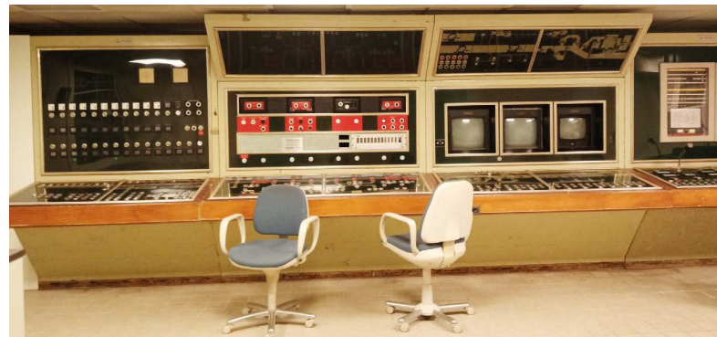
Von der Kommandozentrale aus wurden alle Verschlüsse und die Bunkertechnik überwacht.
