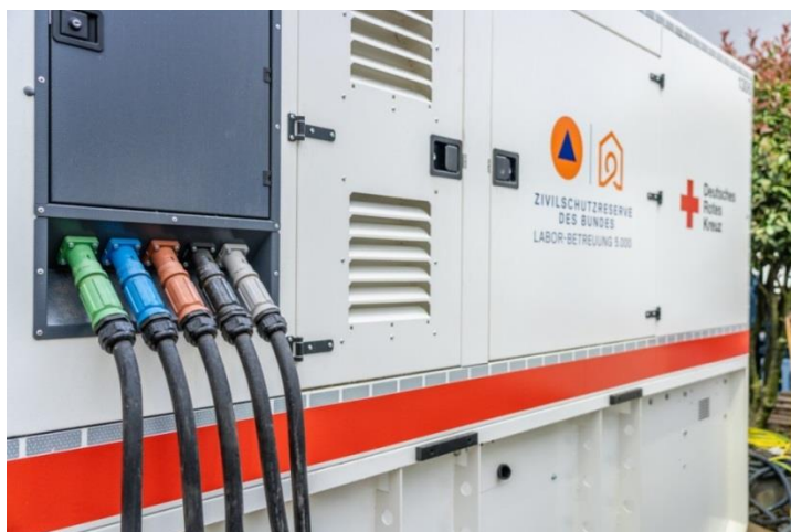
Ersatzstromerzeuger (Netzersatzanlage) mit einer Leistung von 300 kVA Quelle: Köhler / DRK
